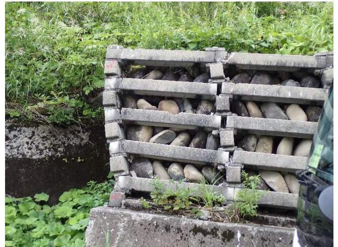
図 24 地すべりによる構造物のゆがみ
